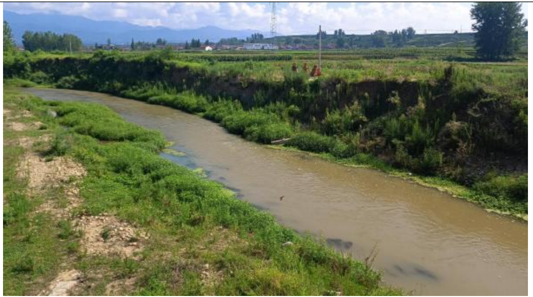
熊家营至赵家坡段被冲刷侵蚀的现状岸坎
