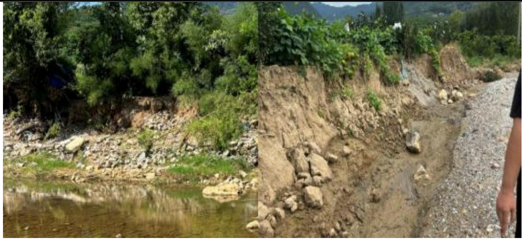
广杨至熊家营段被冲刷侵蚀的现状岸坎
